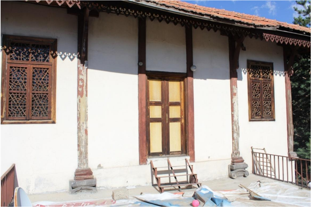
Fotoğraf 199. Erzurum Palandöken Yusuf Ziya Paşa (Nüzhet-ül Hazra) Köşkü Üst Katta Batı Cephede Yer Alan Balkon
