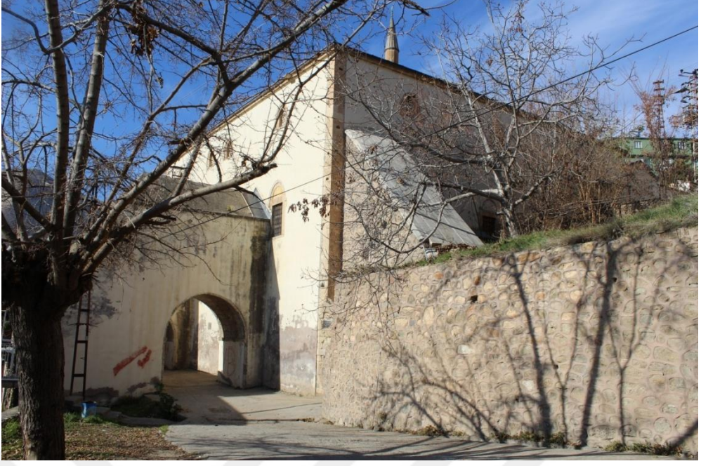
Fotoğraf 59. Keban Yusuf Ziya Paşa Külliyesi Camii Güney Doğu Cephe ve Payanda
