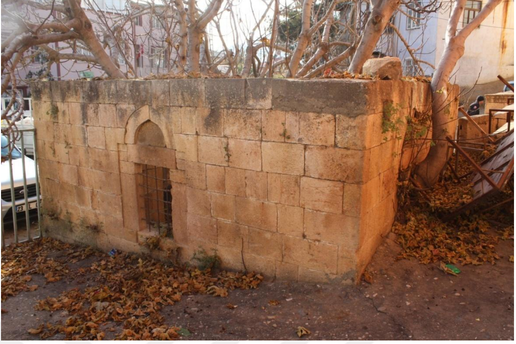
Fotoğraf 156. Keban Yusuf Ziya Paşa Külliyesi'nin Fırat Mahallesi'nde Yusuf Ziya Paşa'nın Kızlarına Ait Türbe Doğu Duvarı
