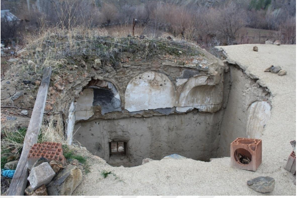
Fotoğraf 178. Elazığ Keban Yusuf Ziya Paşa Konağı Hamamının Yıkılmış Olan Üst Örtüsü ve Trompları
