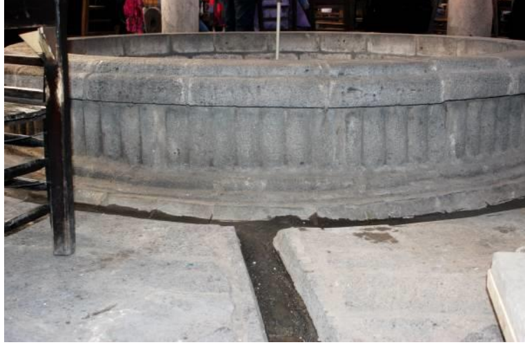
Fotoğraf 206. Hasan Paşa Hanı 1 Nolu Havuz
